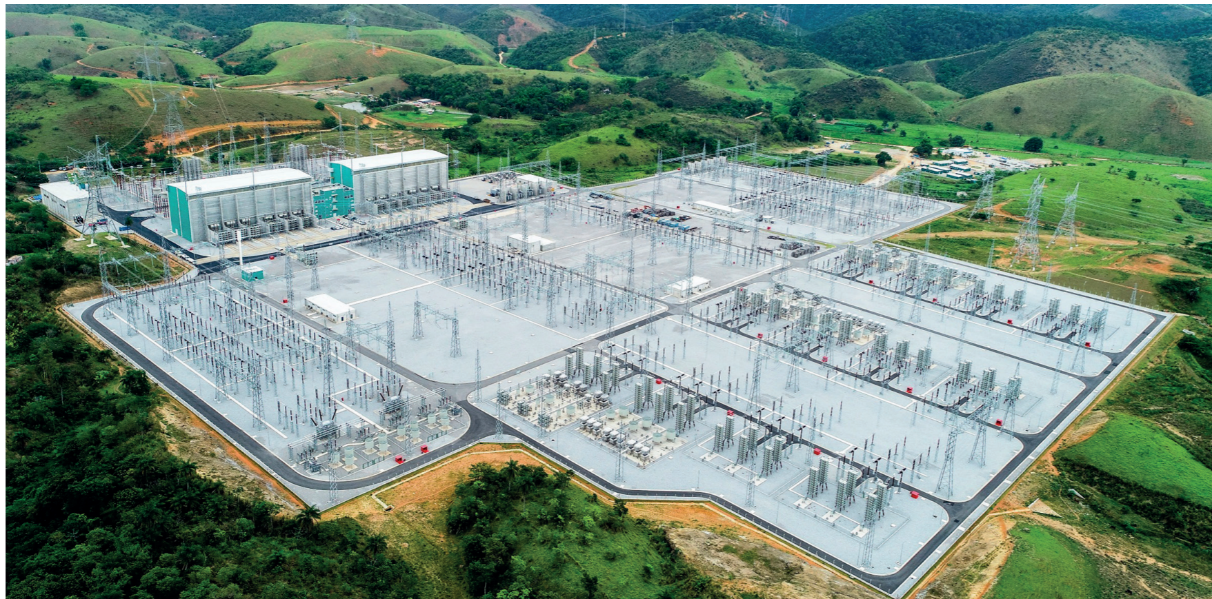
Estação conversora do Rio de Janeiro, parte da segunda linha de transmissão da Usina Hidrelétrica de Belo Monte, construída pela State Grid da China.
